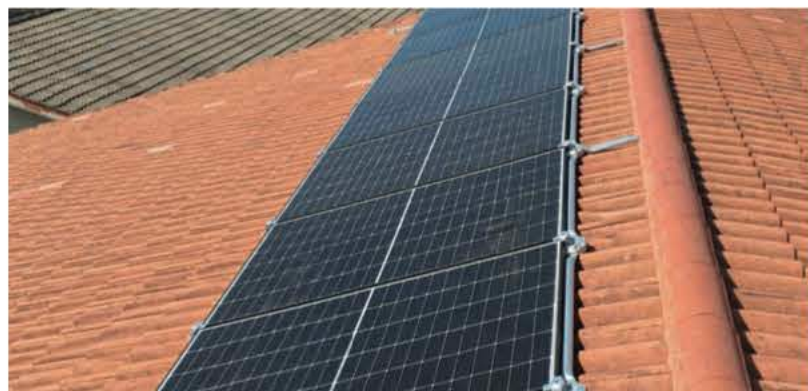
LONATO DEL GARDA (BS) - Potenza 6 kWp
