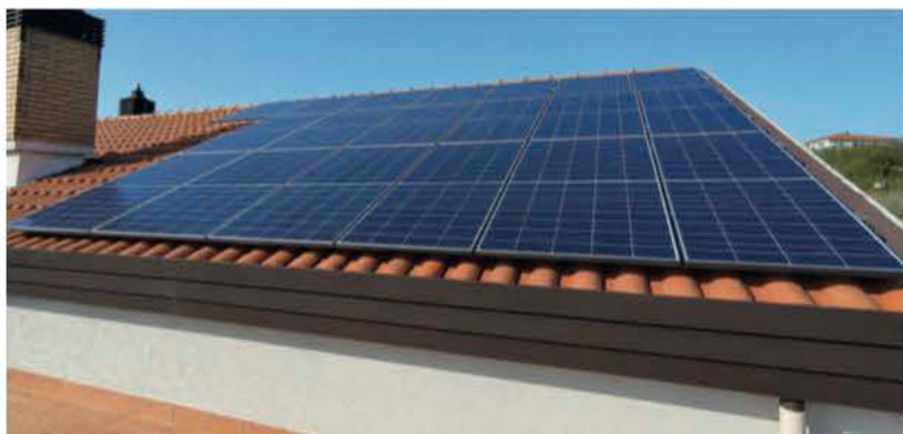
CAPRIGLIA IRPINA (AV) - Potenza 6.3 kWp
