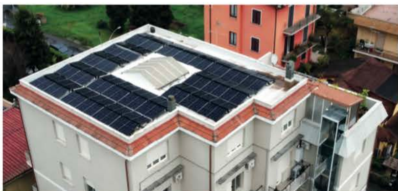
CAVE (RM) - N° 8 impianti da 4 kWp
